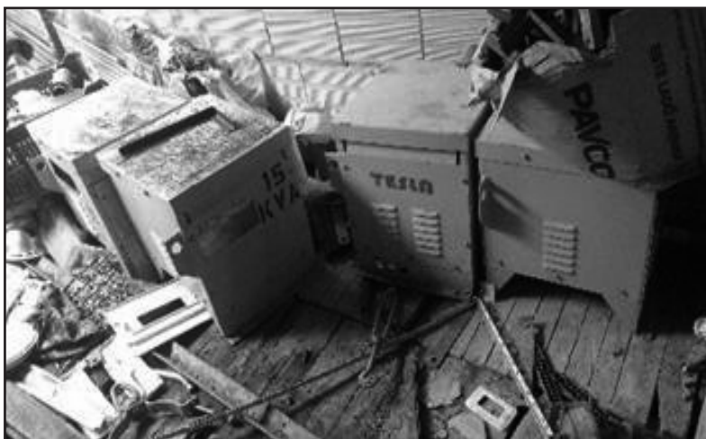
Figura 14. Autotransformadores. Sobraron 4 unidades. Fuente: López J., 2018.
