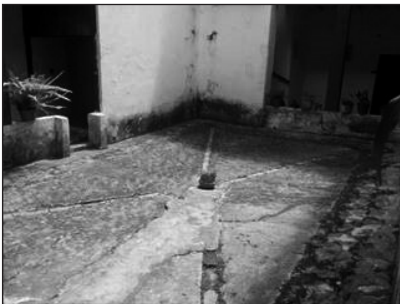
Figura No. 4 Humedades por capilaridad. Patio primer piso. Fuente: Sánchez, 2014.
