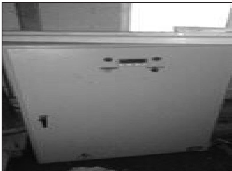
Figura 26. Tablero eléctrico sobró, una unidad. Fuente: López J. 2018.
