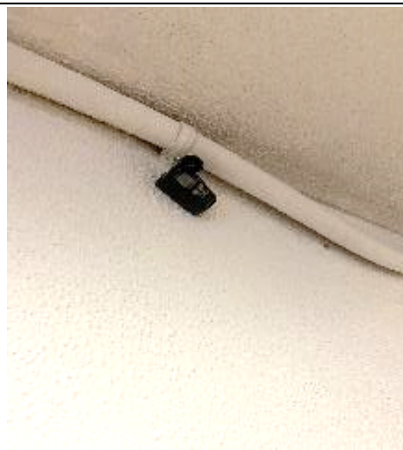
Instalación del Sistema de medición de condiciones ambientales-Datalogger-Archivo central
